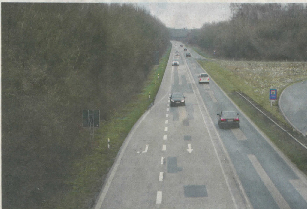
Dringend sanierungsbedürftig: Die Fahrbahn der Kreisstraße 80 ist in schlechtem Zustand Foto: Schult
