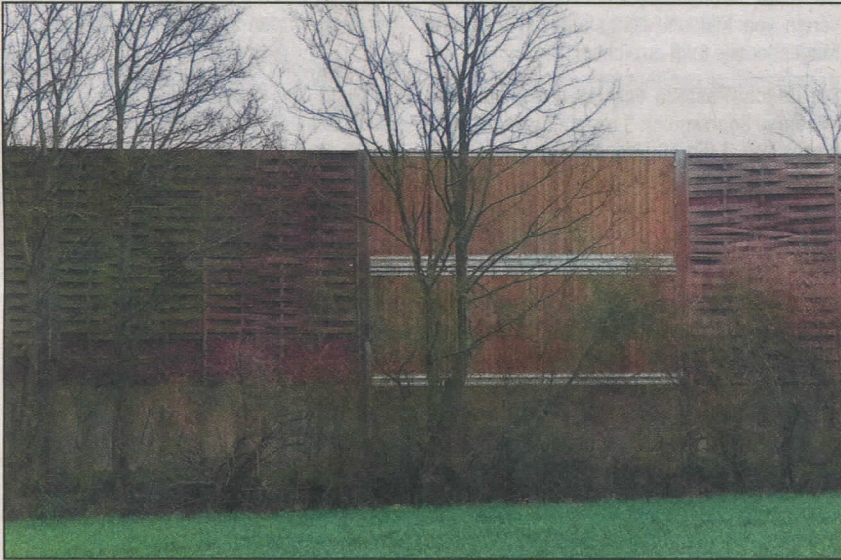
Beschädigung – nach Austausch zweier Zaunfelder Anfang 2014.
